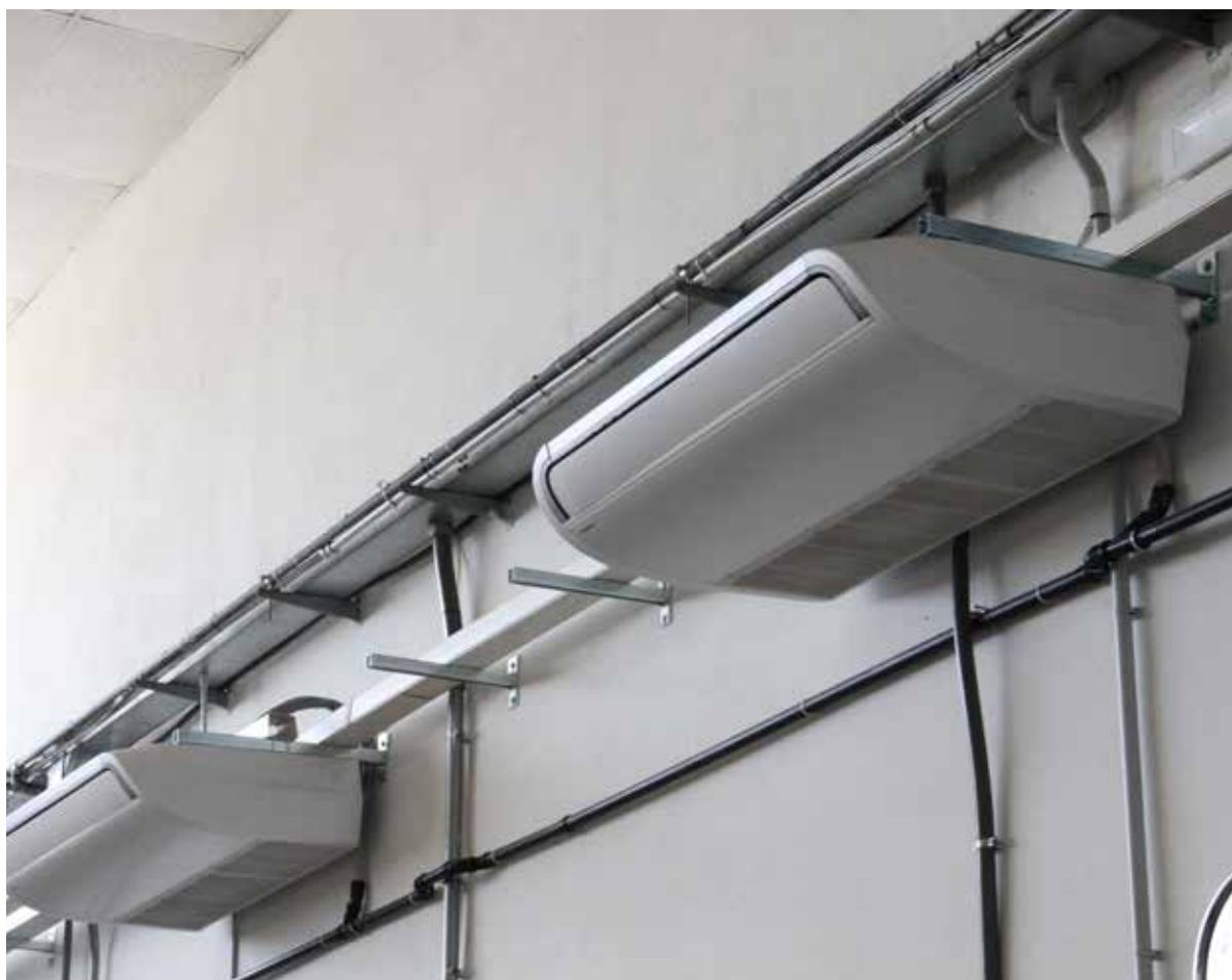
Impianto di condizionamento nel settore produttivo
